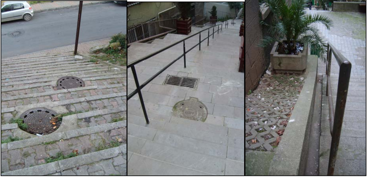
Resim 4.45 Merdivenli sokaklarda alt yapı örnekleri.
