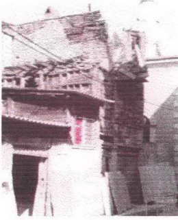
Resim 4. 10 Üsküplü Caddesi üzerindeki yıkık, tescilli yapı. (F.41)
