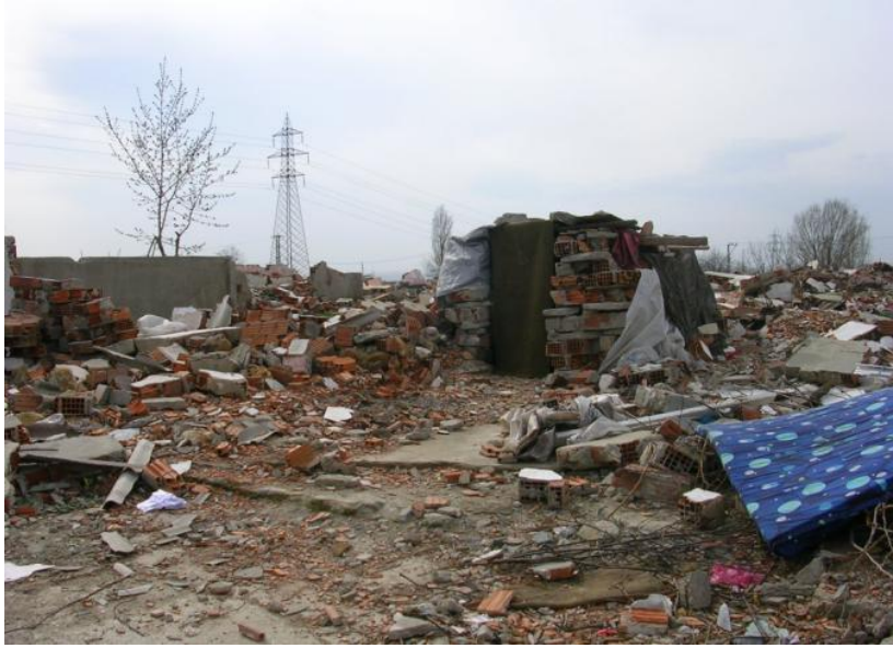
Şekil 5.19. Ayazma Bölgesi Yıkım Alanında Bir Banyo [17]
