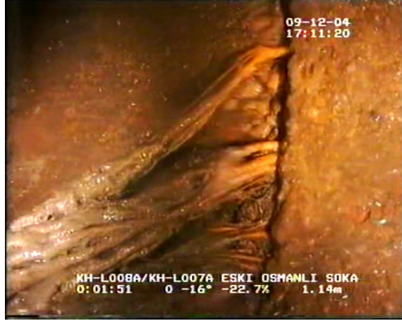
Resim 5.1 Kanalizasyon sisteminde ağaç kökü
