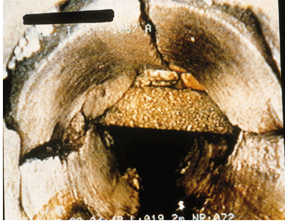
Resim 5.2. Kanalizasyon sisteminde çöküntü
