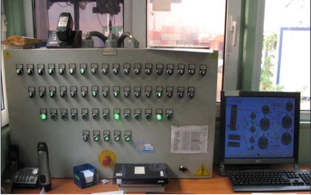
Şekil 4.33 Elektrik ve otomasyon ünitesi
