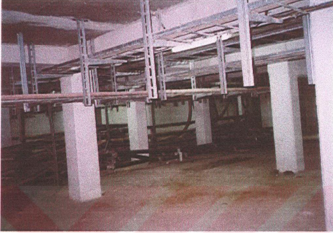
Şekil 6.13 Bodrum kat - kablo galerisi
