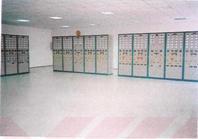
Şekil 6.5 Birinci kat - kontrol odası
