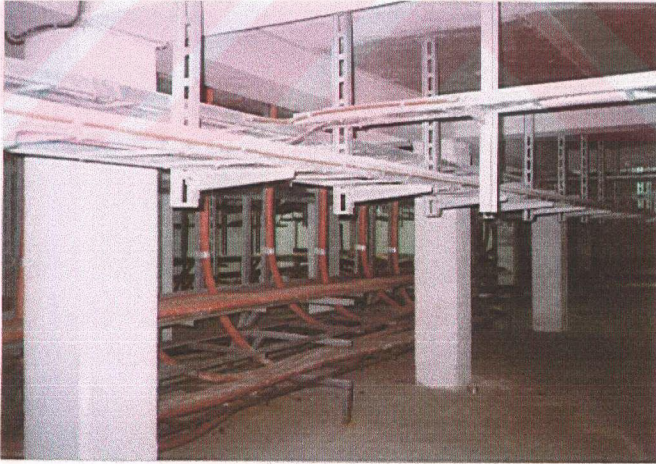
Şekil 6.14 Bodrum kat - kablo galerisi
