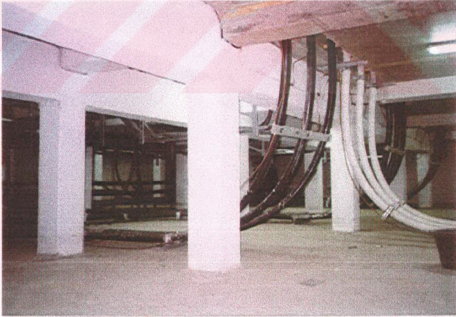
Şekil 6.12 Bodrum kat - kablo galerisi Y.G. kabloları
