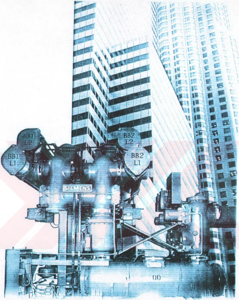
Şekil 5.10 Binanın bodrum katında yapılan GIS tesisi
