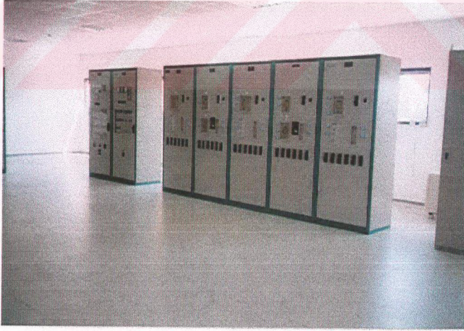
Şekil 6.4 Birinci kat - kontrol odası
