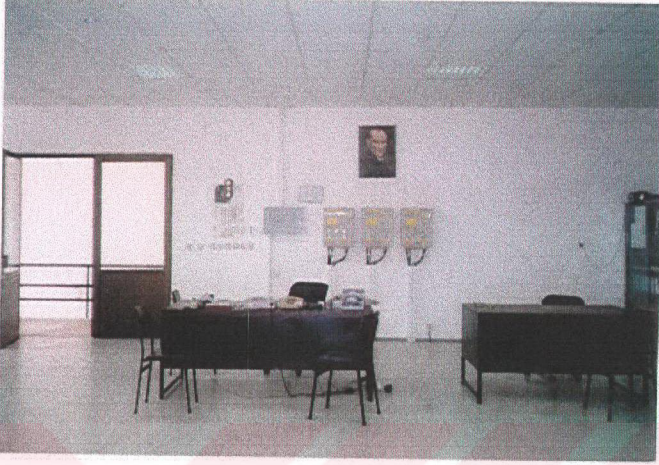
Şekil 6.3 Birinci kat - kontrol odası, görevli tablocu personele ait masalar, yangın ihbar santrali ve trafo yangın koruma panoları
