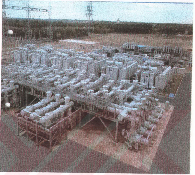
Şekil 5.14 Toshiba firmasının yaptığı 550 kV - 8 kA Higashi Tokyo istasyonu
