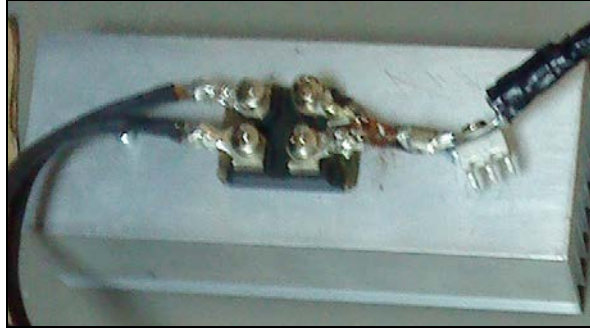
Şekil 6.21 Transformatör çıkışı doğrultucu diyotları
