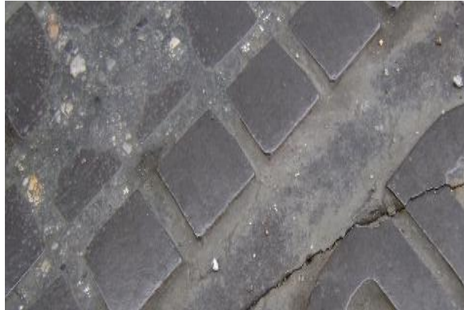
Şekil 6. 3 Çatlamış döküm menhol kapağı
