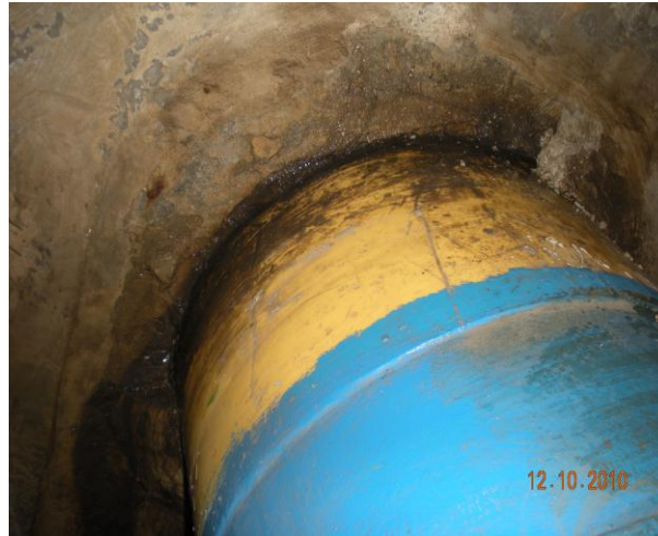
Şekil 6. 9 Boru duvar geçiş yerinden su girişi
