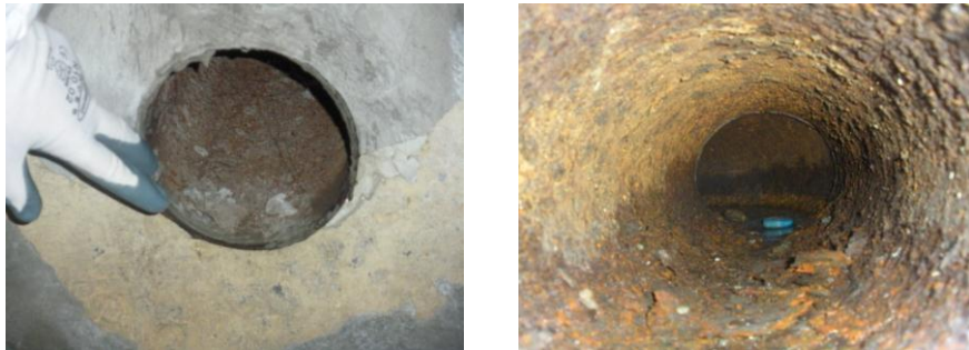
Şekil 6. 7 (a) Baca tipi havalandırma ve (b) havalandırma borusu içi
