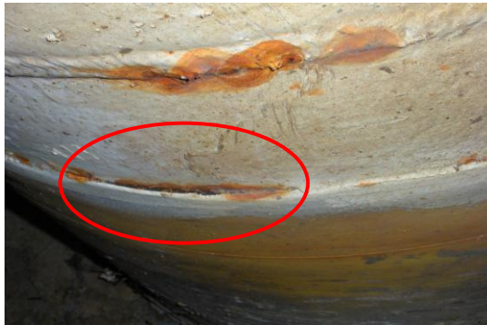
Şekil 6. 13 Kaplama altı korozyonu
