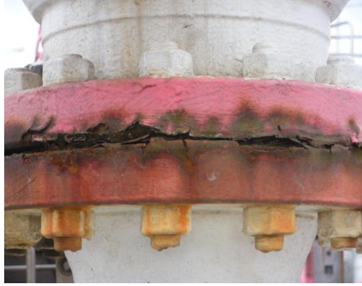
Şekil 6. 18 Flanşlı By-Pass vanalarında aralık korozyonu
