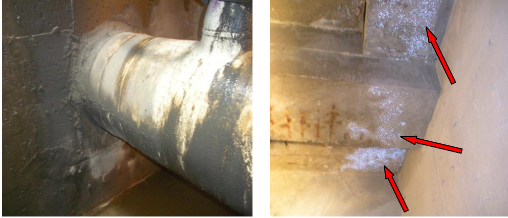
Şekil 6. 20 (a) Boruda kirlilik ve çamur (b) Tavanda nem nedeniyle oluşmuş su damlaları
