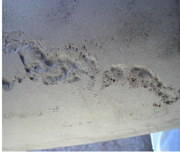
Şekil 4. 7 Boru içinde akıllı pig kullanılarak tespit edilen pitting korozyonu [10]
