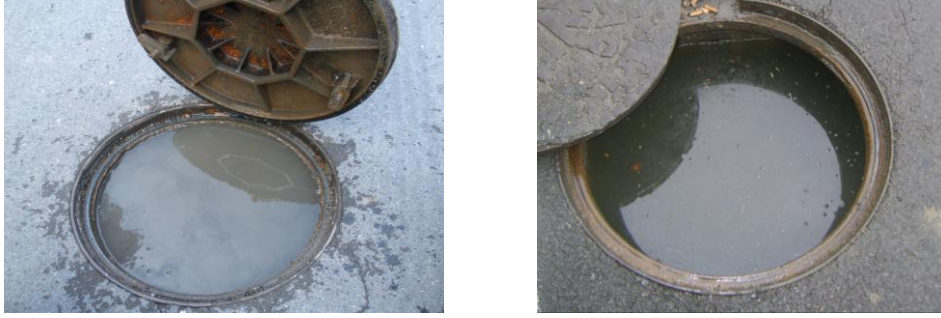
Şekil 6. 12 (a) Yağmur suyu ile dolmuş vana odası (b) kanalizasyon suyu ile dolmuş vana odası
