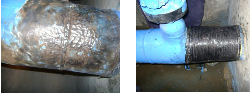
Şekil 7. 21 (a) Korozyonlu bölgenin tamir öncesi ve (b) Kompozit tamir uygulaması
