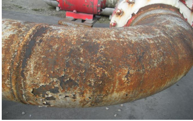
Şekil 5. 2 Doğal gaz borusunda genel korozyon oluşumu
