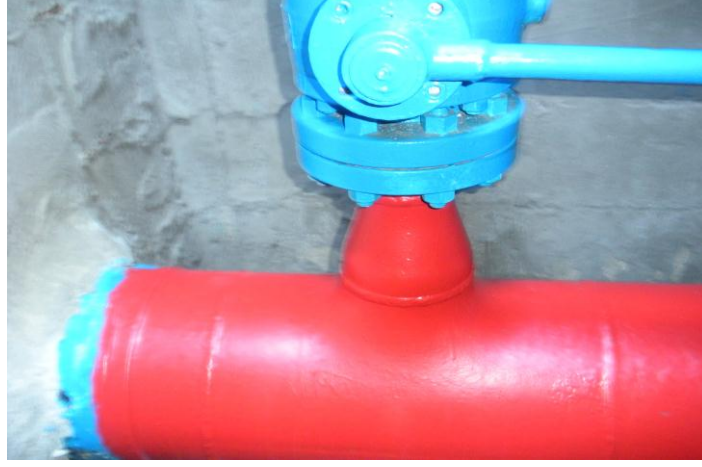
Şekil 5. 27 Yeni boyanmış doğal gaz boru ve vanası
