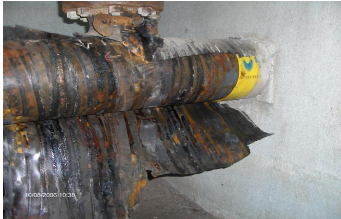
Şekil 6. 21 Hatalı sıcak sargı uygulaması sonrası oluşmuş korozyon
