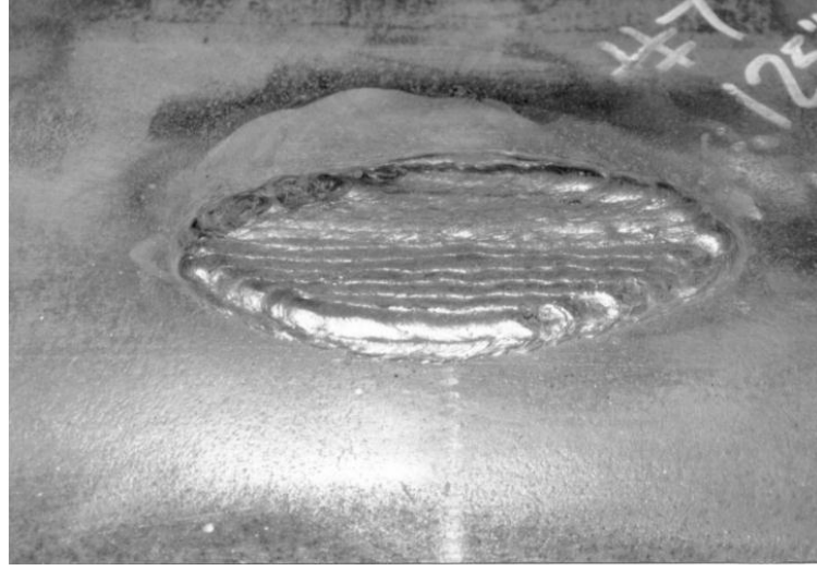
Şekil 7. 8 Gazlı boruda pitting korozyonu üzerine yapılmış dolgu kaynağı pasoları [45]
