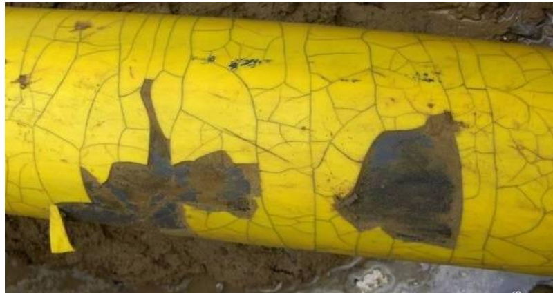
Şekil 6. 17 Polietilen kaplamanın gevrekleşip çatlaması
