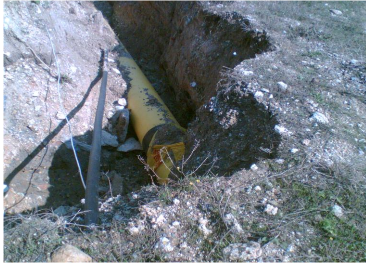
Şekil 4. 2 Toprak kayması sonucu açığa çıkmış doğal gaz borusu
