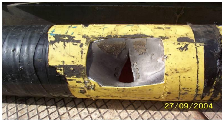
Şekil 4. 3 Alt yapı çalışmaları esnasında hasar görmüş doğal gaz borusu
