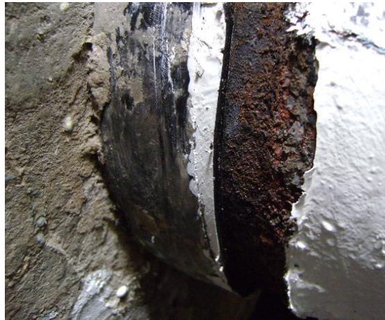
Şekil 6. 15 Kaplama (boya) altı korozyonu
