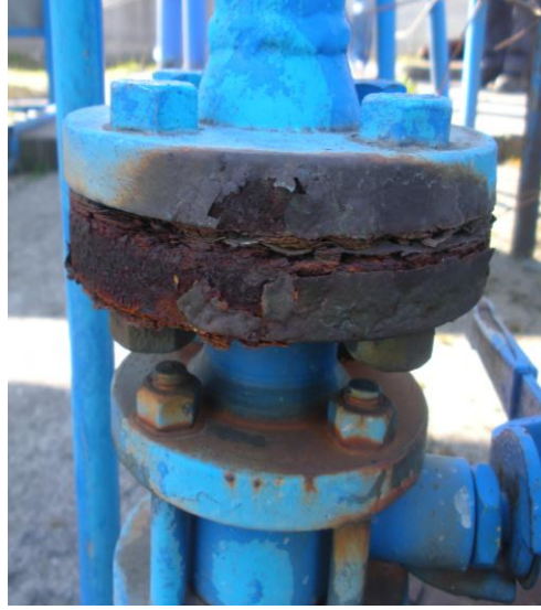
Şekil 5. 4 Flanşta aralık korozyonu
