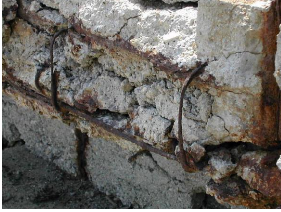
Şekil 5.4 Korozif aşınmaya bir örnek
