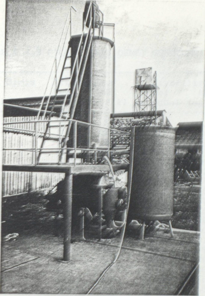
RESİM 1 PILOT TESİSİN GENEL GÖRÜNÜŞÜ
