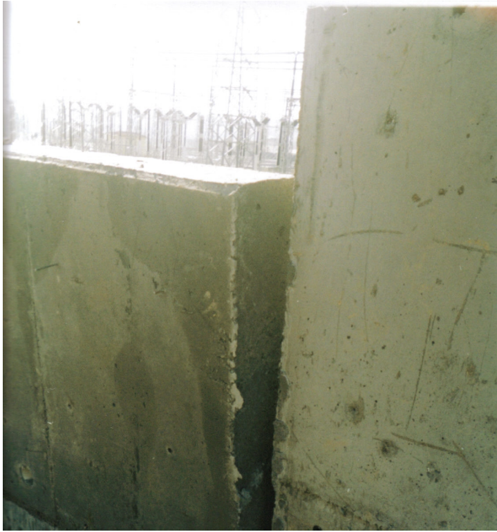
Resim 13.1 İstinat duvarındaki ayrılma
