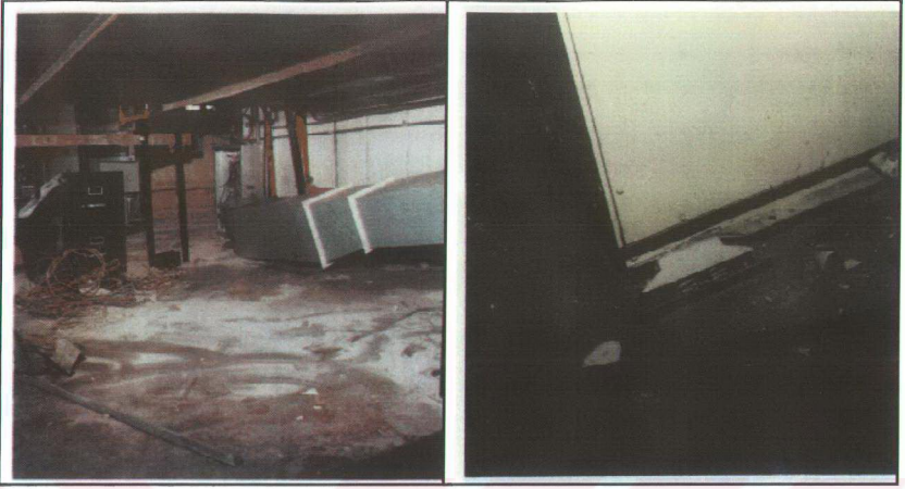
Şekil 5.5 Sağ üstte Havalandırma kanalları deprem sonucu devrilmiş durumda, sol üstte ise chiller ünitesi sadece titreşim sönümleyici yaylarla sabitlendiği için yay ayakları kırılmış durumda.
