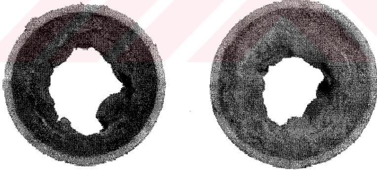
Şekil 1.1 Soğutma suyu borularının bir seneden daha az bir sürede filtrasyon yapılmamış durumu [6].
