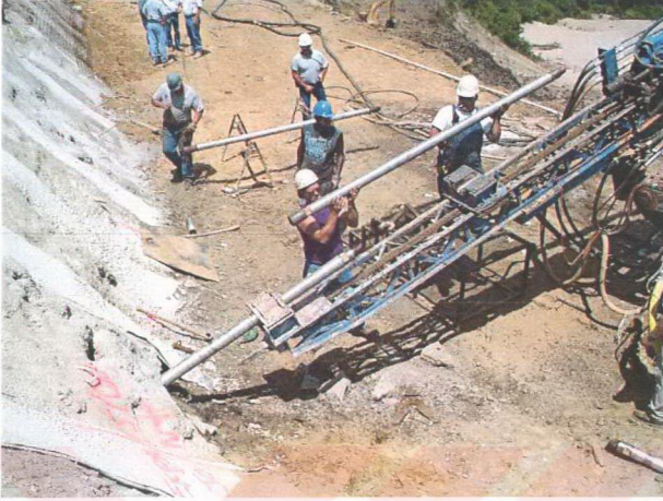
Şekil Ek 1.3 Çivi tesisi için yapılan delgi, kazı yüzeyinin stabilitesi düşük olduğundan delgi öncesi püskürtme beton uygulanmış.
