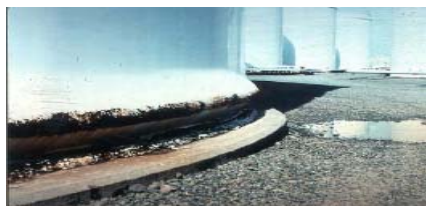
Şekil 4.27 İzmit Tüpraş LNG Tankları kauçuk sismik taban yalıtkanı (Forni, 2005).
