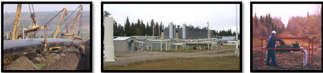
Şekil 2.23 Doğalgaz İletim Hattı, Kompresör İstasyonu ve Yer Vanası [28]
