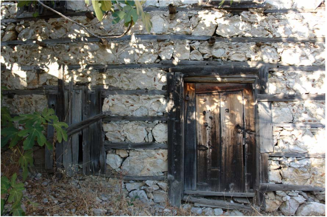
Şekil 5.42 Yapının güney cephesinde zemin katta kapatılmış pencere ve kapı
