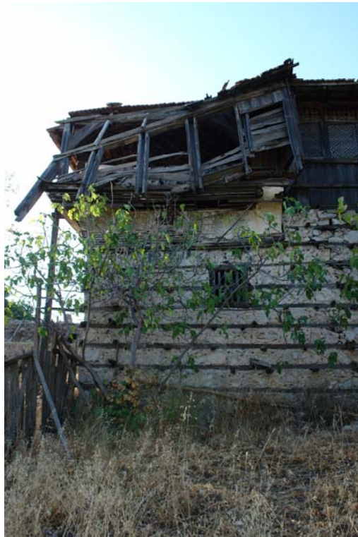
Şekil 5.47 Yapının doğu cephesinde şahnışinde çökme
