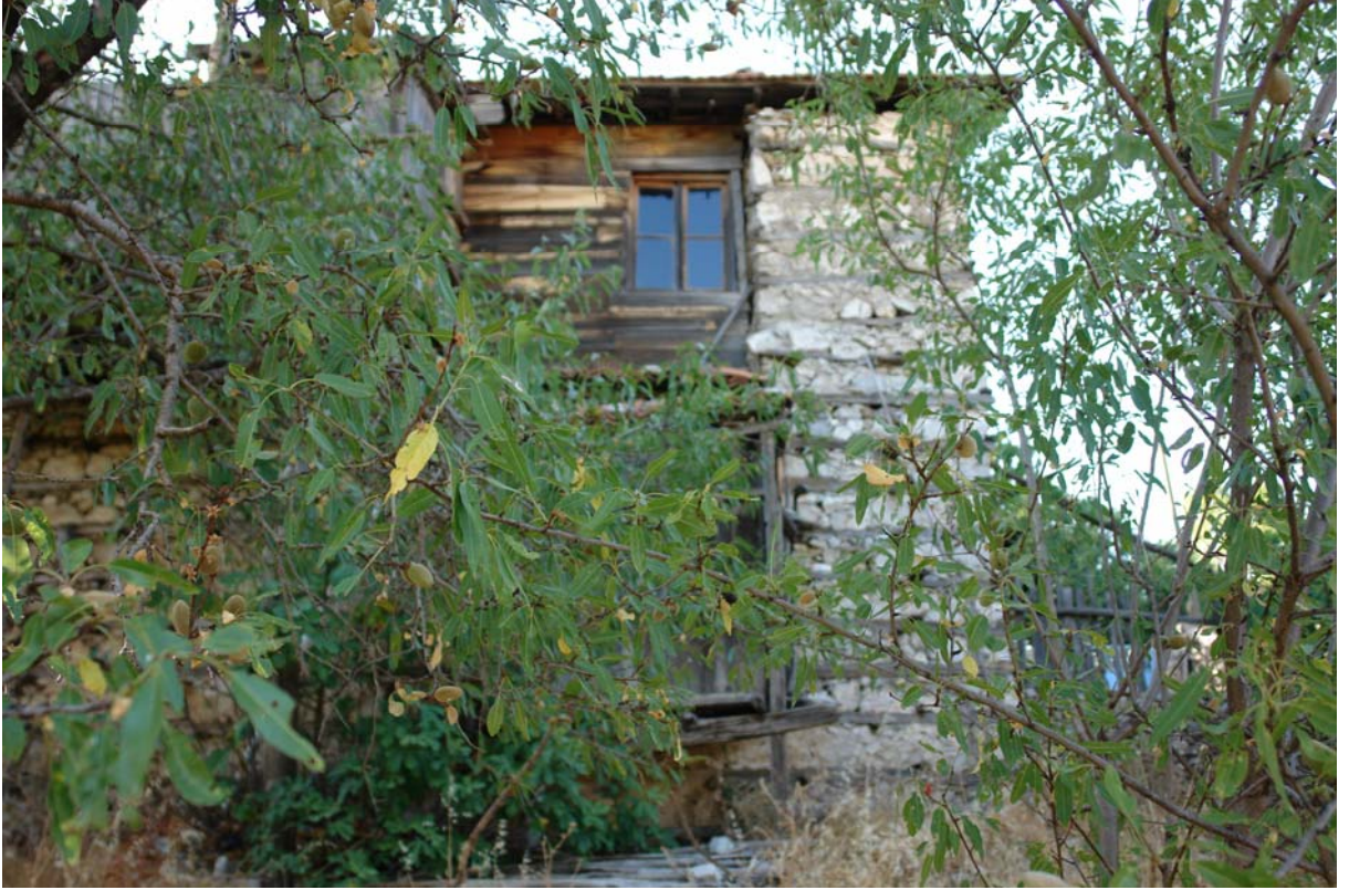
Şekil 5.48 Yapının doğu cephesinde kısmen yıkılmış taş duvar ve muhdes pencere
