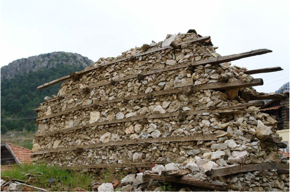
Şekil 4.11 Yıkılmış duvarda harçsız kuru duvar
