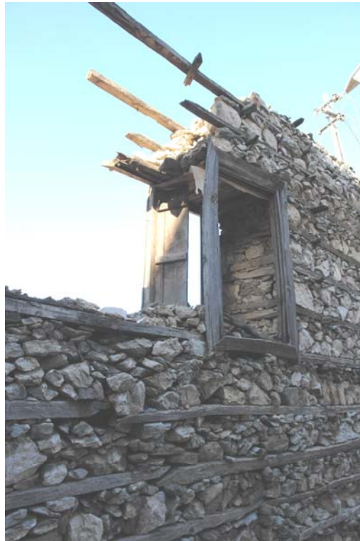
Şekil 4.58 Yıkılmış yapıda pencere boşluğunun örgüsü
