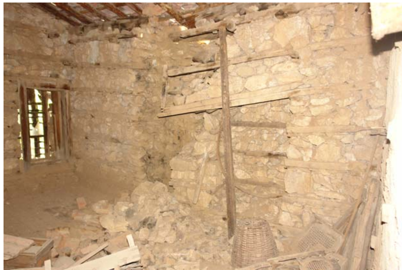
Şekil 5.29 106 no'lu odada kısmen yıkılmış taş duvar
