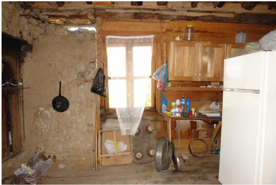
Şekil 5.25 105 no'lu aşıklıkta kısmen yıkılmış taş duvar
