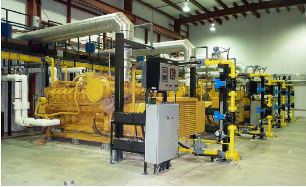
Şekil 3.1 Pistonlu Gaz Motorundan Elektrik Üretim Tesisi [27]
