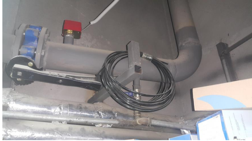
Şekil 3. 18 Yangın tesisatı proje uygulama hatası
