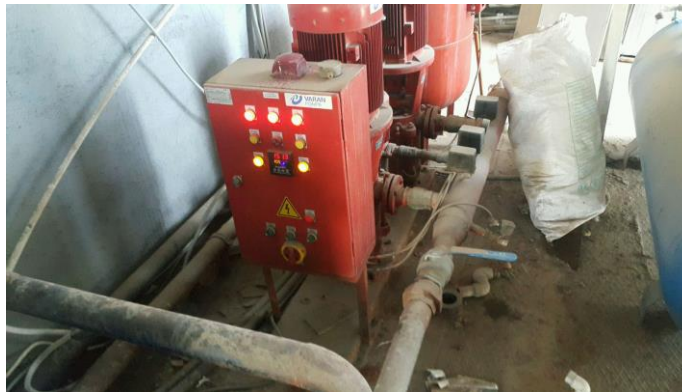
Şekil 3. 23 Uygunsuz pompa istasyon örneği
