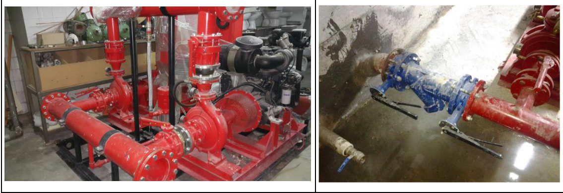
Şekil 3. 22 Devreye alınmamış pompa istasyonu ve besleme hattında pislik tutucu kullanılması
