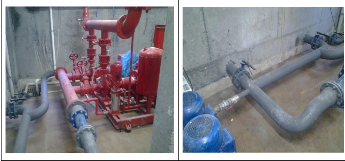
Şekil 3. 24 Pompa emiş hattında proje harici hatalı uygulama [25]
