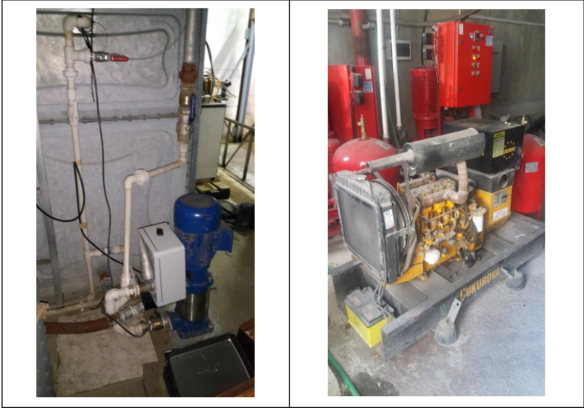
Şekil 3. 26 Yetersiz yangın pompası ve uygunsuz pompa bağlantıları ile jeneratör egzoz çıkışı hatası
