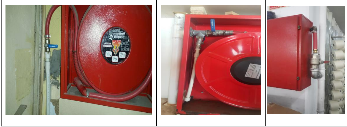
Şekil 3. 28 Uygunsuz yangın dolabı tesisat bağlantı hata örnekleri
