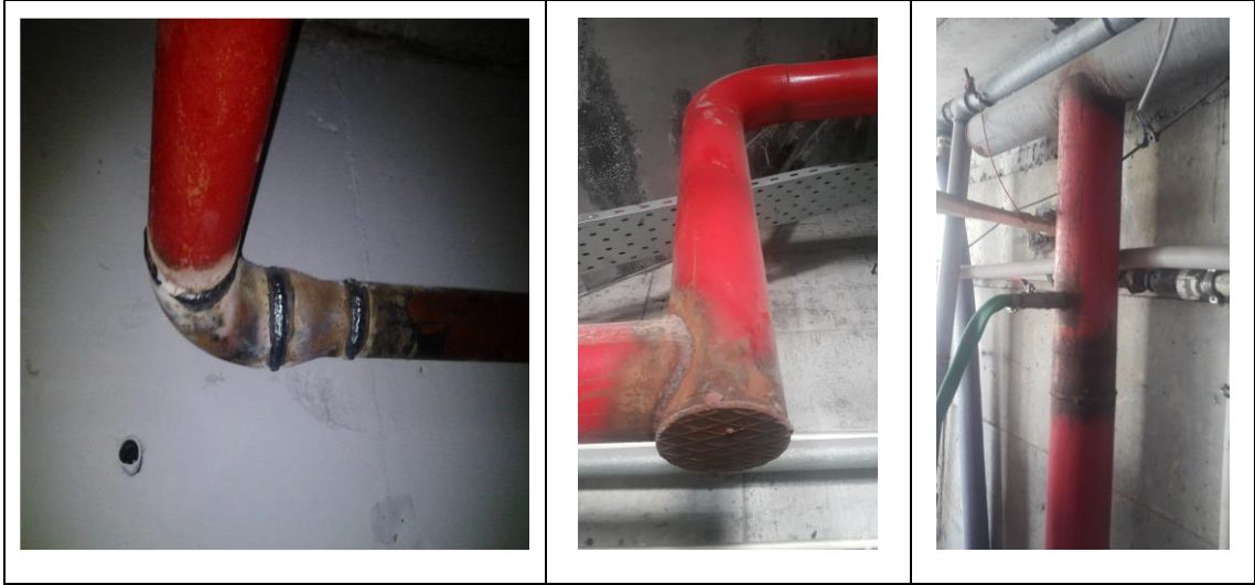
Şekil 3. 30 Sabit boru tesisatı boya, yama kaynağı ve farklı amaç hataları
