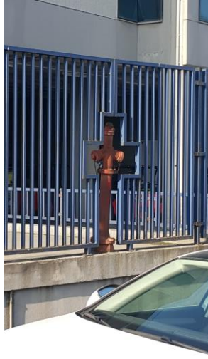
Şekil 3. 31 Hidrant bağlantı ağzlarının engellemesi
