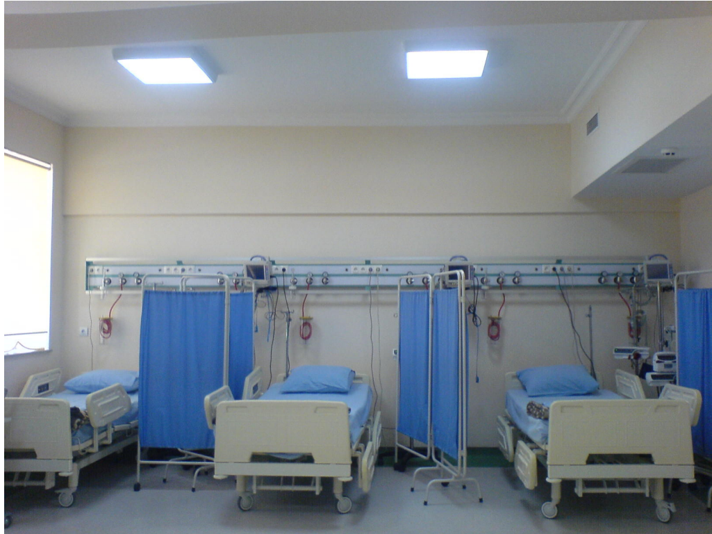
Şekil 3.7 Acil odası aydınlatması
