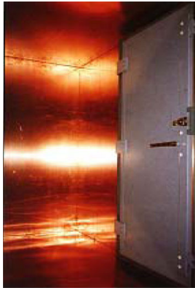
Şekil 8.3 MR odası bakır kalkan uygulaması 2
