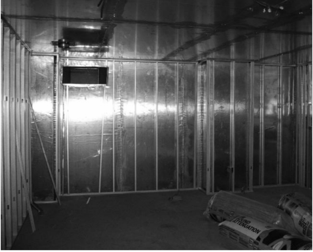
Şekil 8.2 MR odası bakır kalkan uygulaması 1
