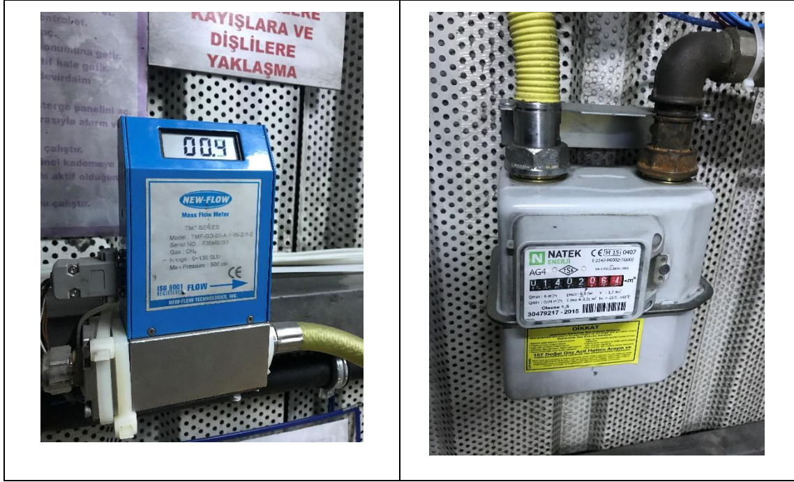
Şekil 3.12 a) Gaz akış ölçer, b) doğalgaz saati
