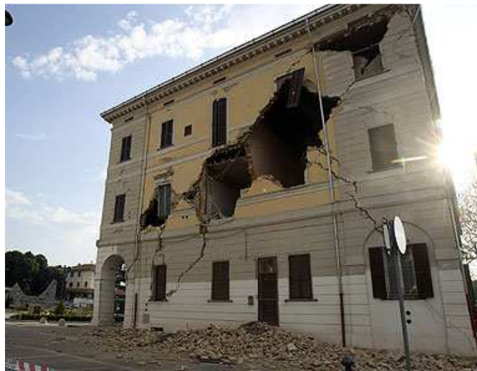
Şekil 4.184 Depremden Hasar Görmüş Bir Yığma Yapı
