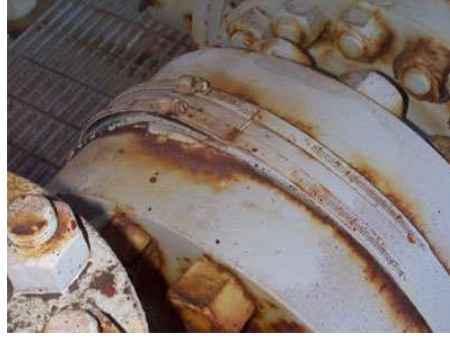
Şekil 2.9 Aralık korozyonuna uğramış flanş [20]
