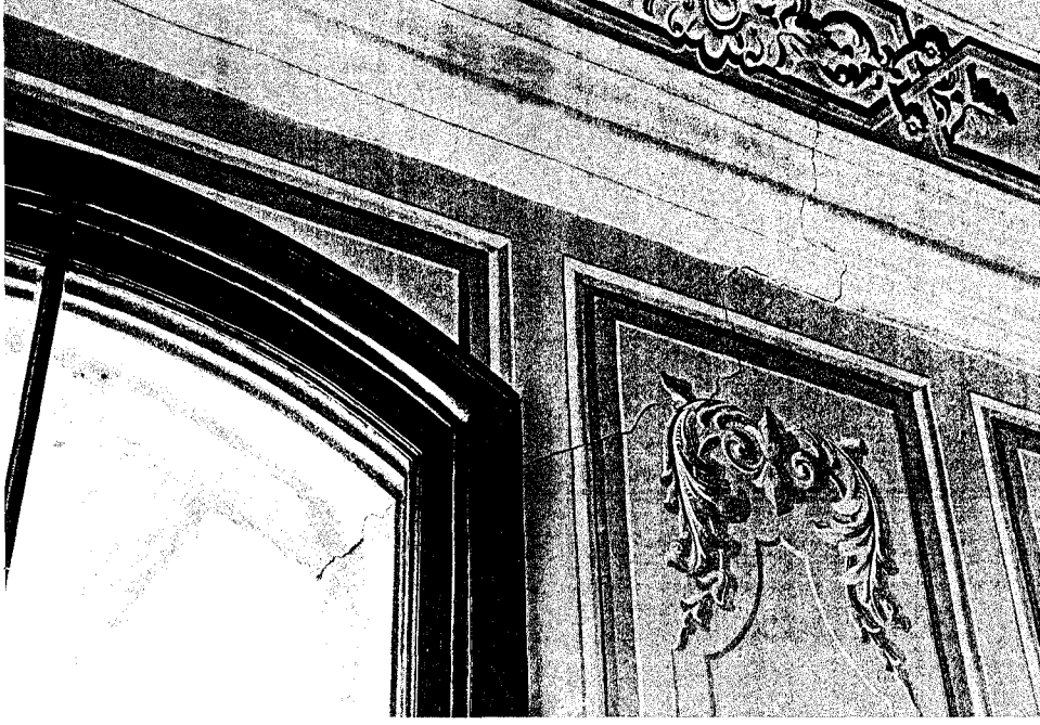
Fotoğraf 4.1 HK 14 Pencere kenarındaki deprem çatlağı
