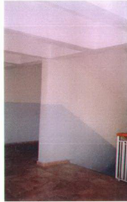
Şekil 6.31 Körler okulunda merdiven kovası yer döşemesi.
